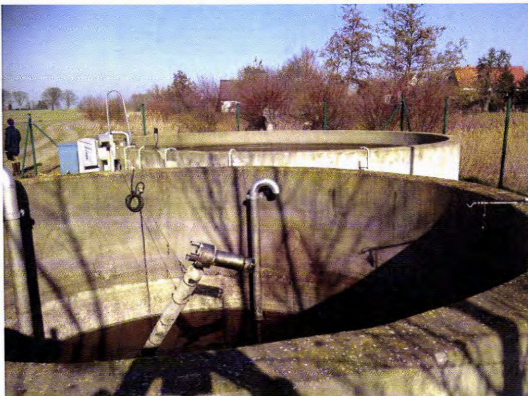
Abbildung 5: Schlamm-speicher (Vordergrund) und SBR Becken (Hintergrund)
