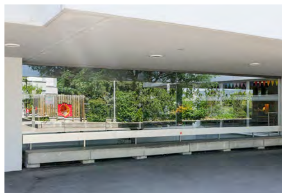
Obwohl das Gebäude mehrere Meter ausragt, sind an den Fenstern deutliche Spiegelungen zu erkennen. Schattenwurf eliminiert die Spiegelungen nicht.
