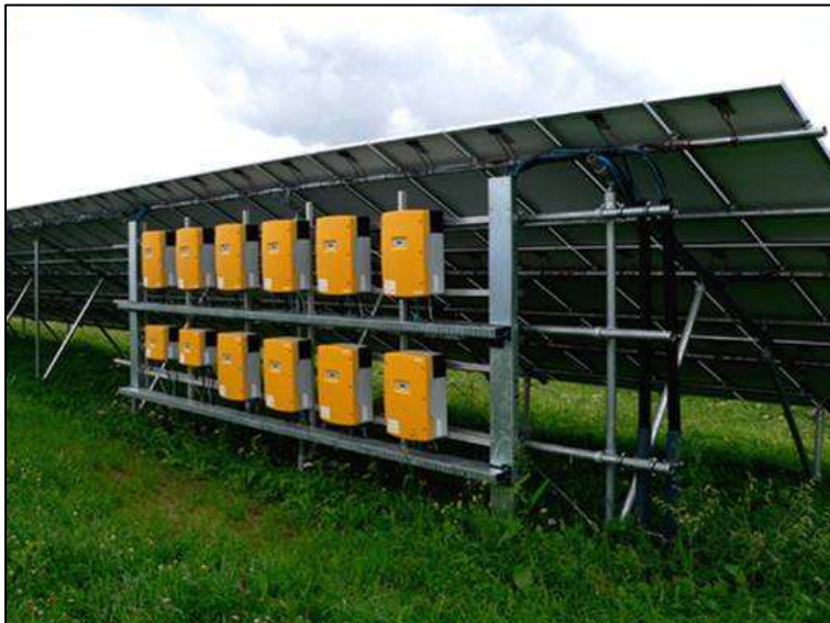
Abbildung 20: Rückansicht der Module. Die verschatteten Flächen weisen eine geschlossene Vegetationsdecke auf.
