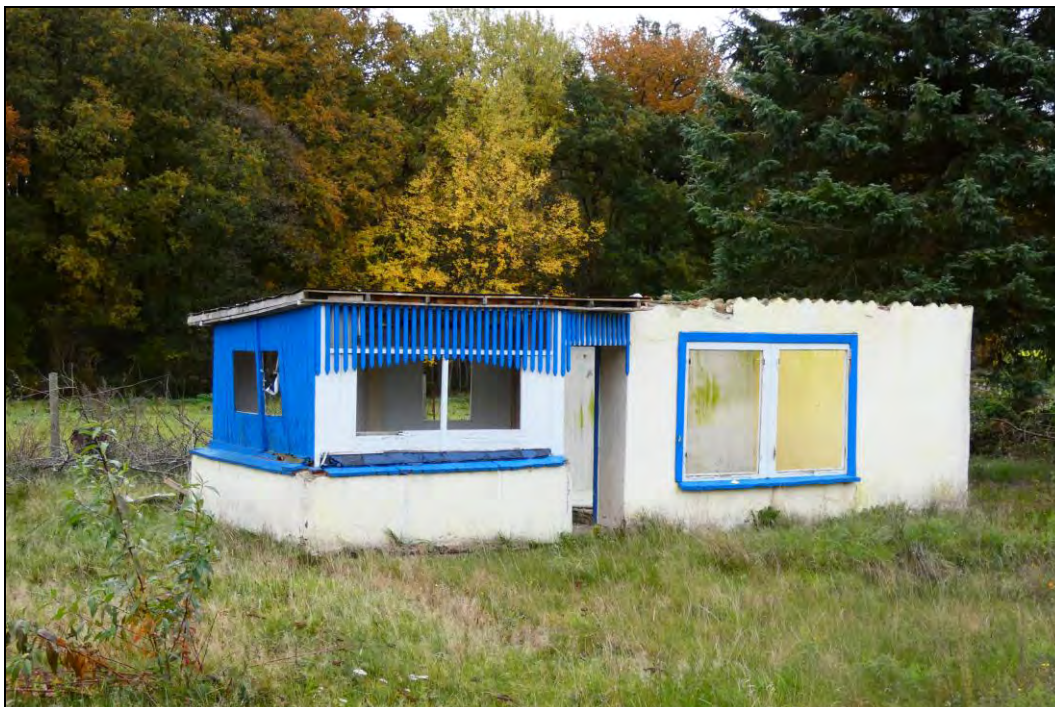
Abbildung 4: Ansicht der aufgelassenen und teilweise entkernten Gartenlauben (zwischenzeitlich abgebrochen und beräumt).
