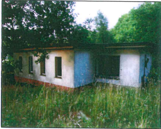
Abb. 2: Gebäude 13. Der östliche Teil befindet sich noch im Rohbau. Die Zwergfledermauswochenstube konnte in der Deckenspalte im mittleren Raum vorgefunden werden
