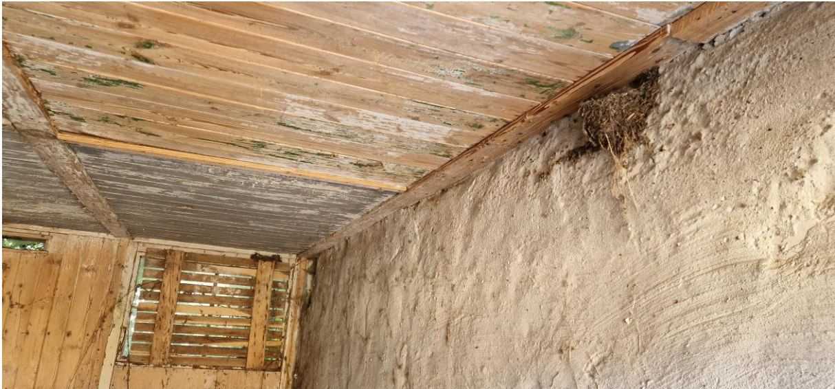
Abbildung 34: Im Innenbereich des Gebäudes Nester der Rauchschwalben.
