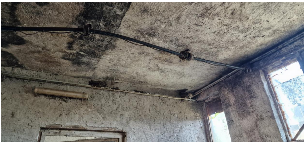
Abbildung 14: Hier gab es zahlreiche besiedelte Rauchschwalbennester auf den Kabeln an der Wand und an der Decke.
