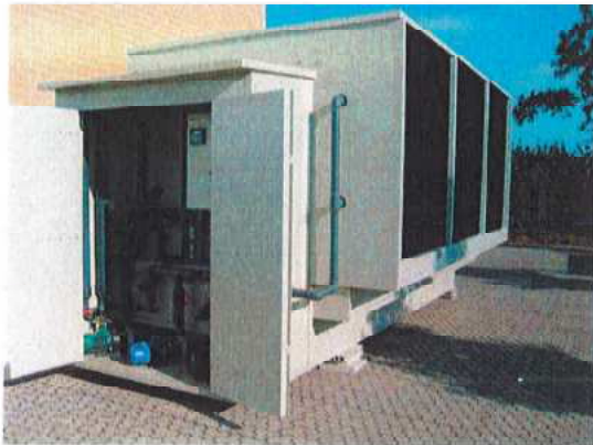
Abluftreinigungsanlage, im Vordergrund das Pumpenhaus, im Hintergrund das Filtermaterial (Lamellenpakete)
