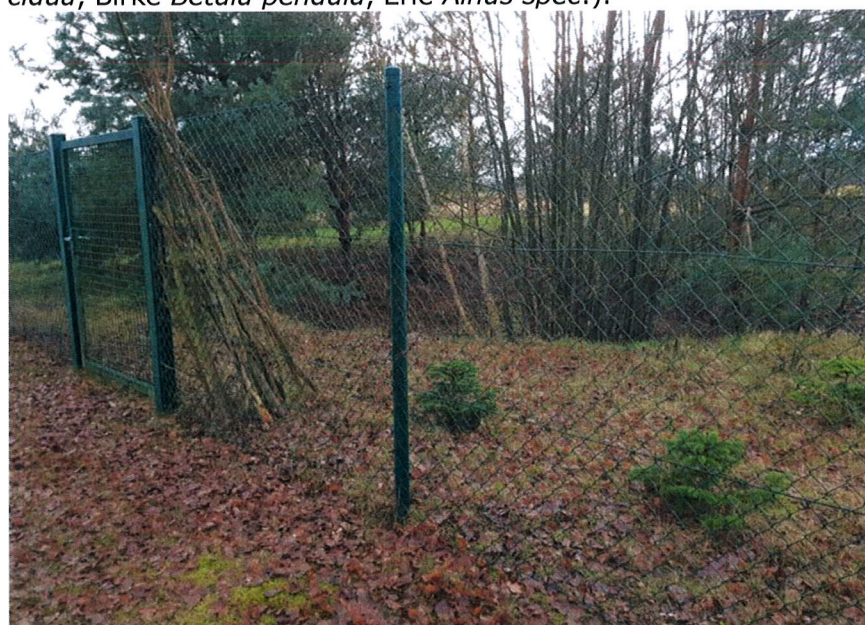
Abbildung 3: Gehölzaufwuchs innerhalb des umzäunten Regenrückhaltebeckens, Foto Rommel
