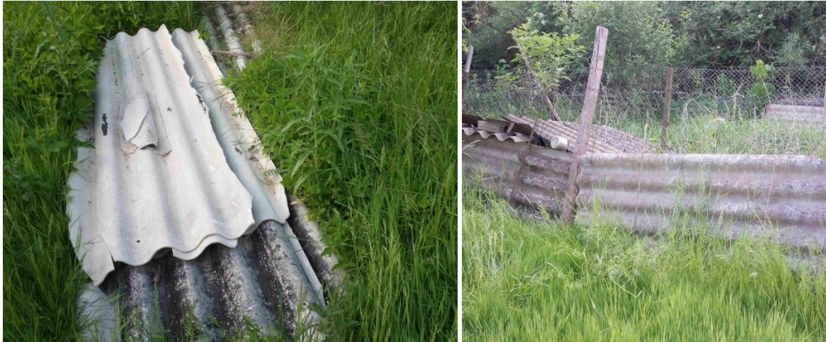
Abbildung 8: Asbestzementplatten im Untersuchungsgebiet, Fotos vom 22.05.2024
