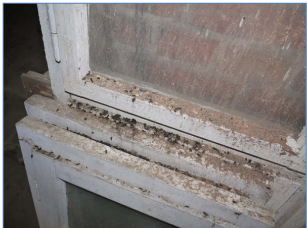
Abb. 7 Fledermauskot unterhalb des Hangplatzes auf abgestellten Fenstern.
