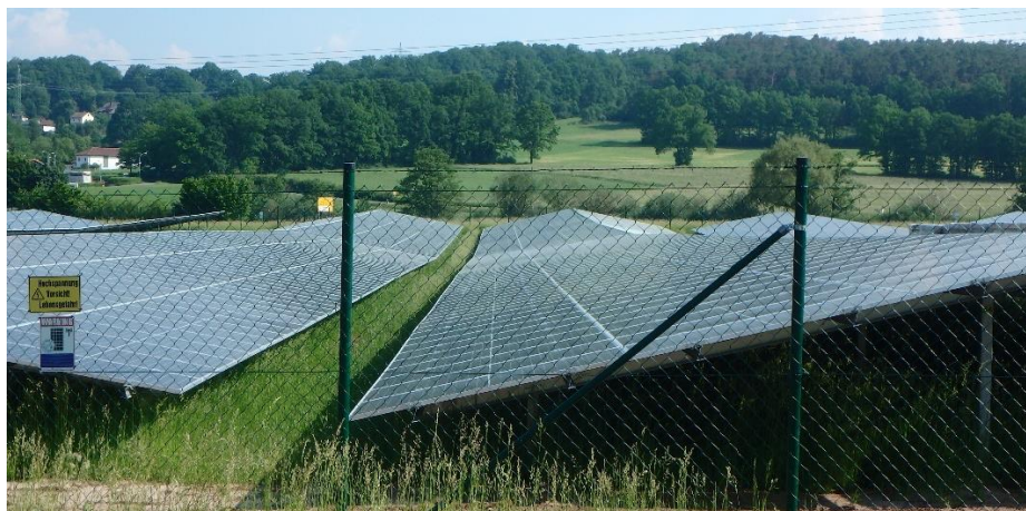
Abbildung 1: Beispiel einer Ost-West-Anlage
