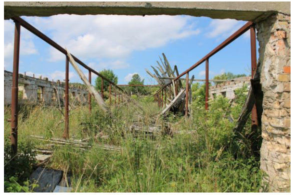
Abbildung 12 Ruine der ehemaligen LPG-Anlage
