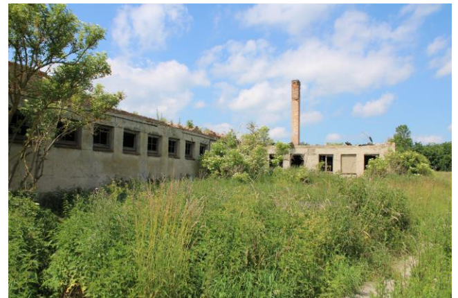
Abbildung 16 Ruine der ehemaligen LPG-Anlage
