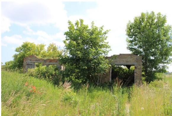
Abbildung 13 Ruine der ehemaligen LPG-Anlage
