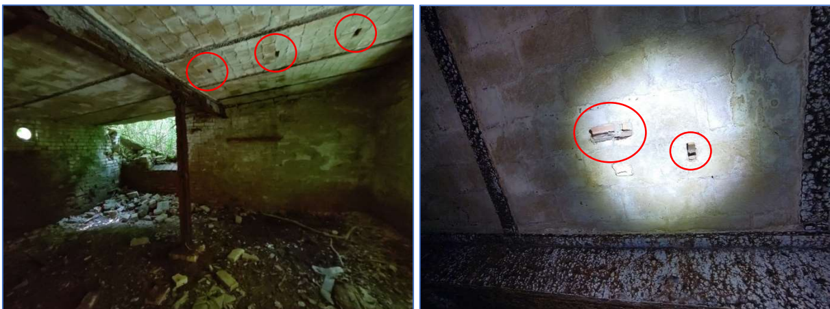
Abb. 40 und 41 Versteckplätze in Spannkeraamikdecke des Nebengebäudes.
