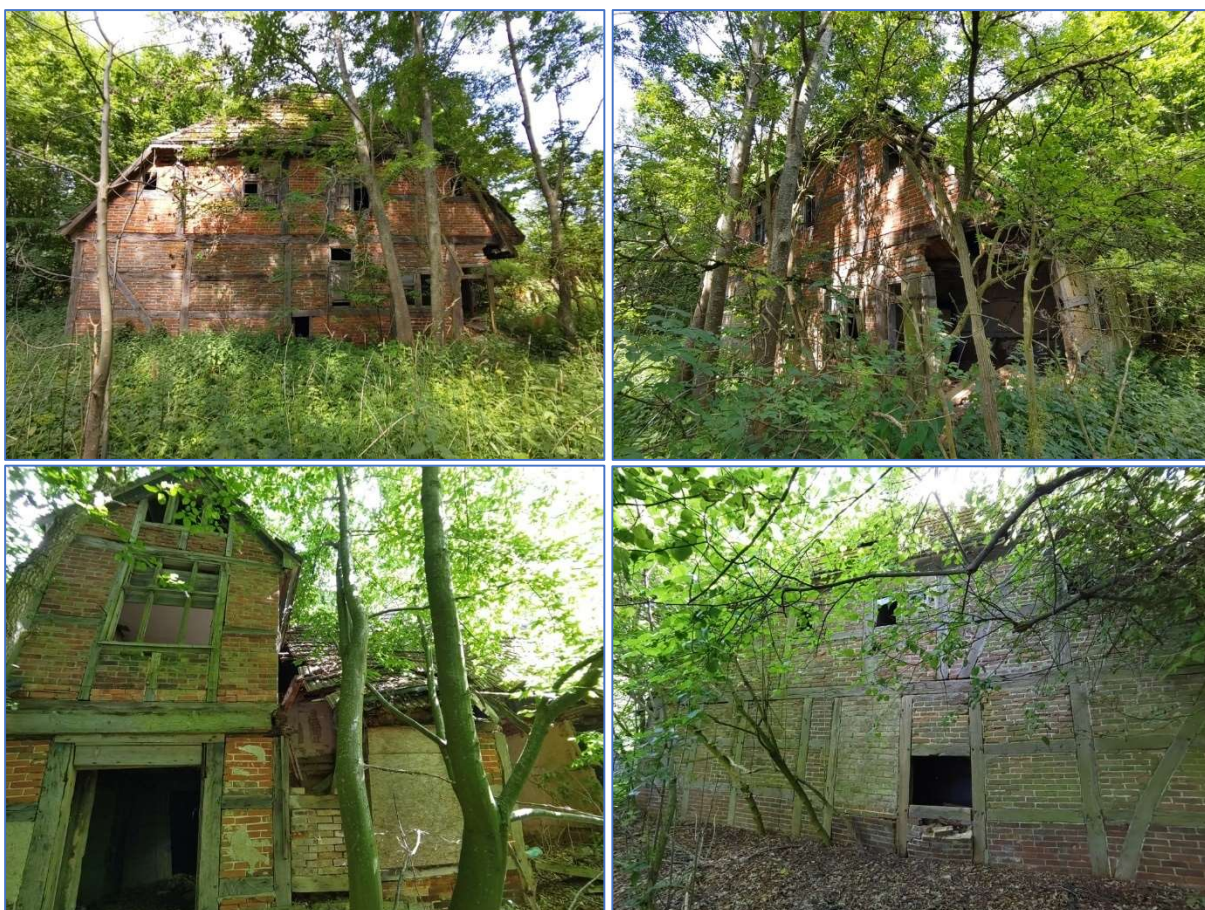
Abb. 18 bis 21 Außenansichten des ruinösen ehem. Gutshauses.
