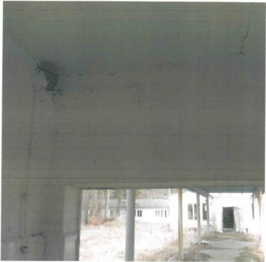
Abb. 3 Rauchschnalbenester im südlichen Gebäude (Beispiel für zahlreiche Nester)
