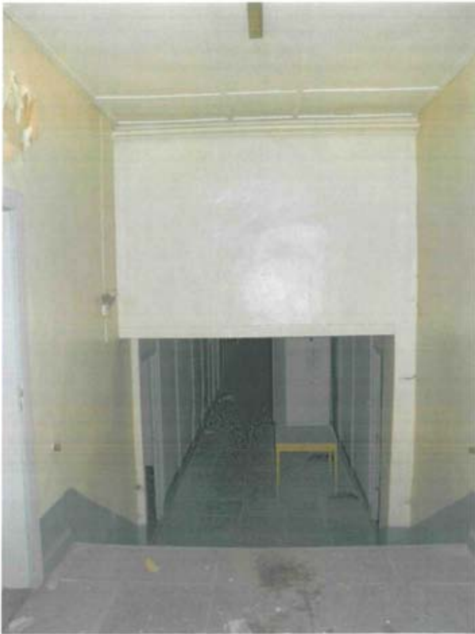
Abb. 4 Quartierbereich mit Kotspuren von Fledermäusen an der Wand (Spaltenquartiere jeweils in den Deckenspalt oberhalb der Treppen) im nördlichen Gebäudetrakt (Rauchschwalbennest links im Bild zu sehen, Kotspuren eines weiteren Nestes am Boden im Vordergrund)
