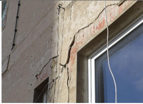
Spalten unter Fugenrissen
