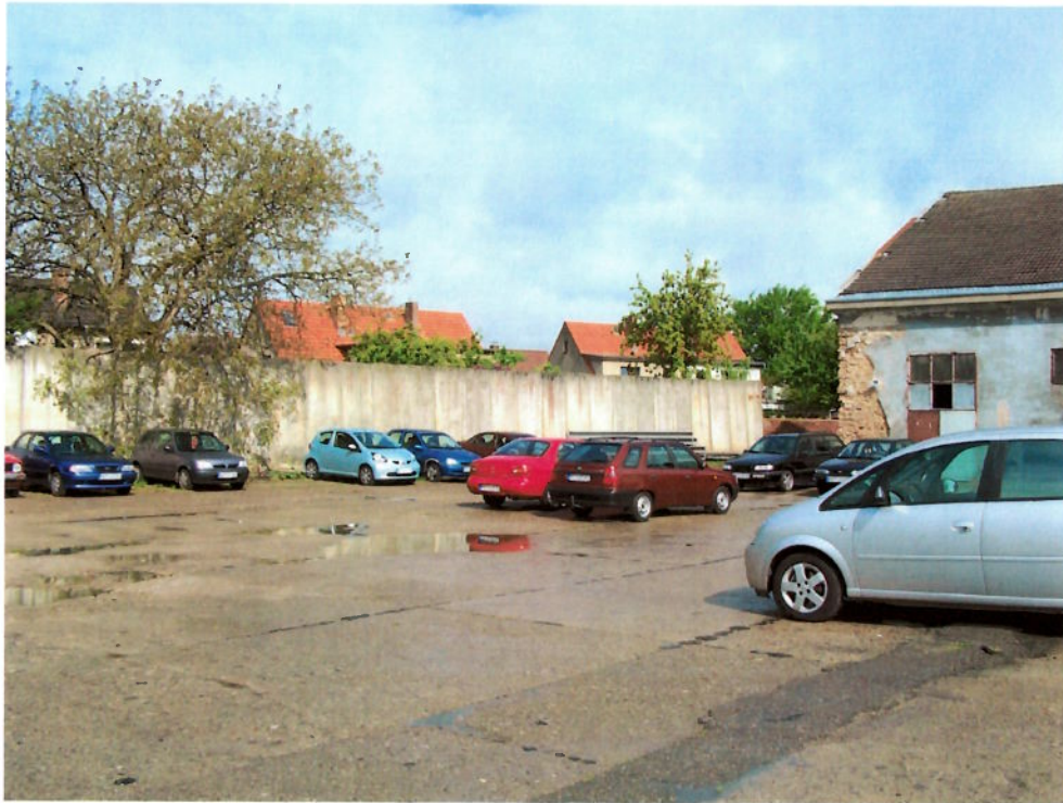
Mit großen Betonplatten vollständig versiegelter Parkplatz.
