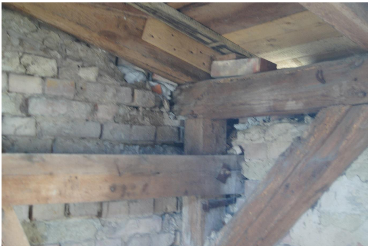
Bild 15 Spalten und Einflugmöglichkeiten im Obergeschoss
