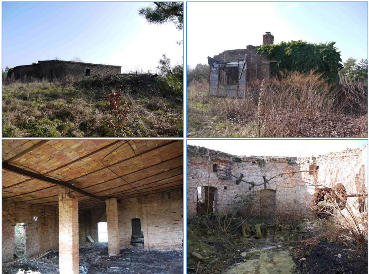
Abb. 4 bis 7 Ansichten des ruinösen Gebäudebestandes
