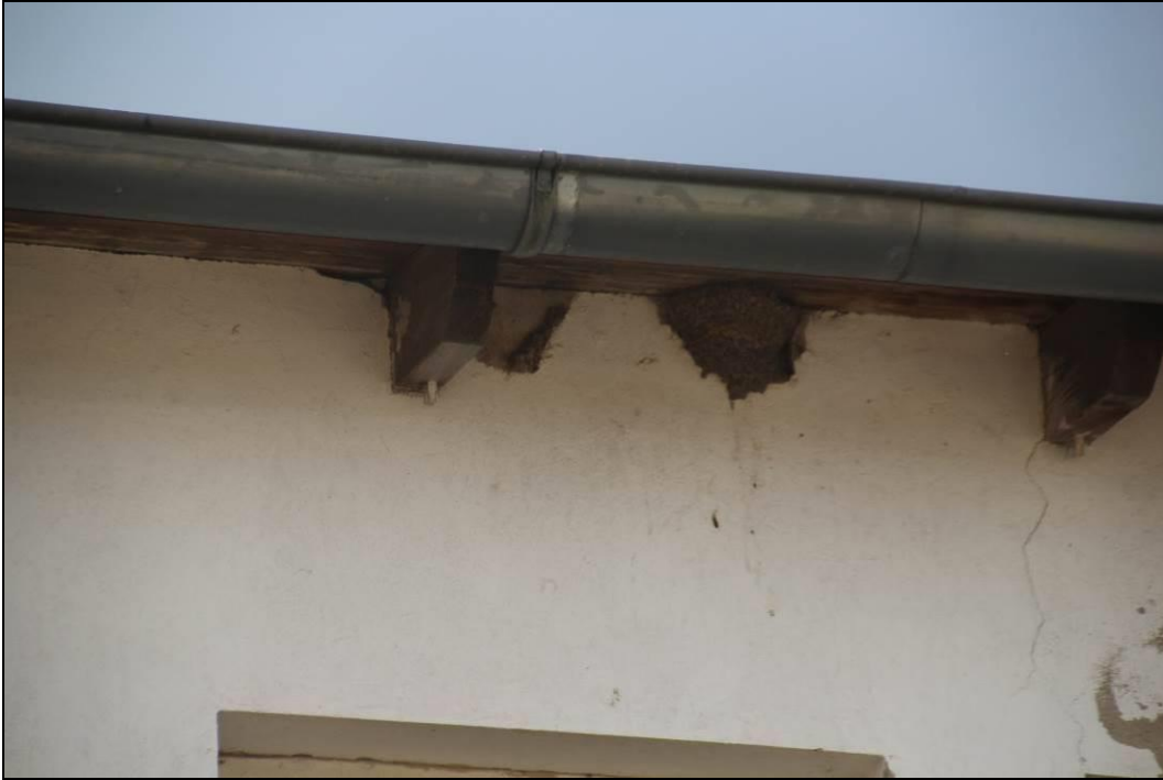
Abbildung 39: Mehlschwalbennest an der Ostfassade des Gebäudes 1b. Dieses Nest wurde im Jahr 2020 nicht mehr genutzt. Offenbar ist der Parasitenendruck zu groß.
