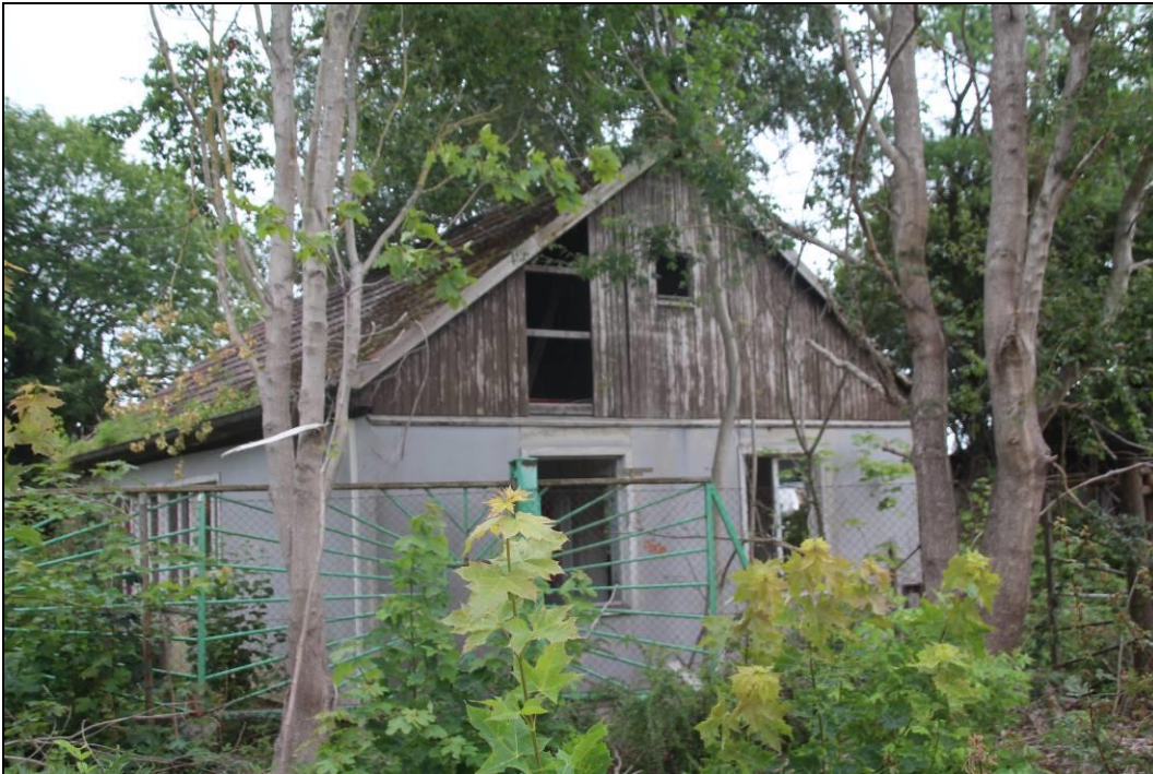
Abbildung 17: Gebäude 3 im ruinösen Zustand.
