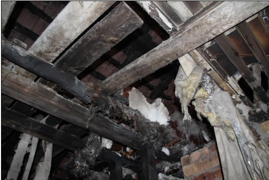
Abbildung 7: Brandschaden im Dachbereich des Gebäudes 1b.
