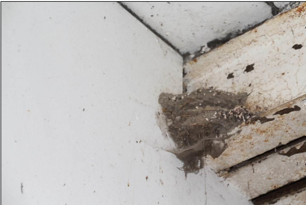
Abbildung 40: Rauchschalbennest im alten Heizhaus der ehemaligen Gärtnerei (Gebäude 5).
