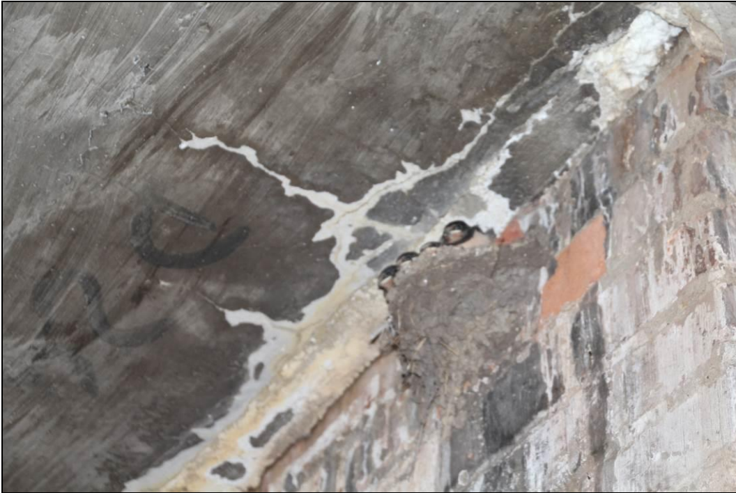
Abbildung 34: Rauchschwalbennest mit Jungtieren im Gebäude 5
