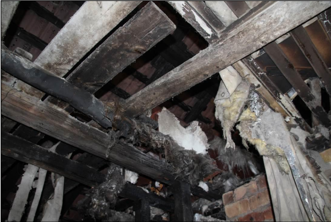
Abbildung 7: Brandschaden im Dachbereich des Gebäudes 1
