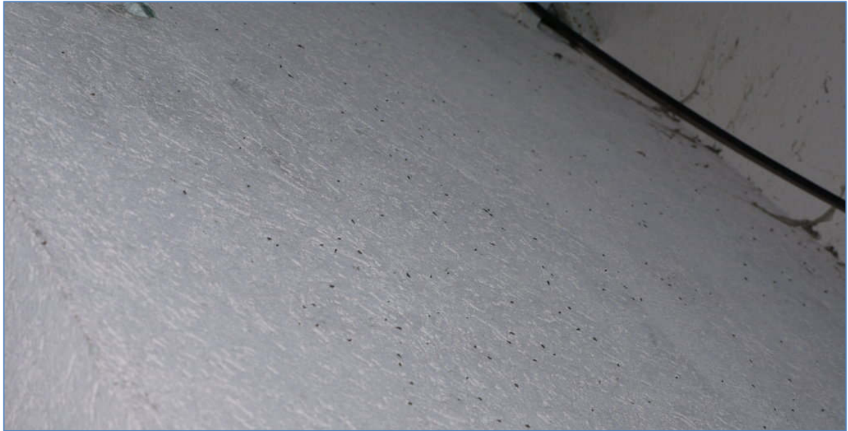
Abb. 23 Fledermauskot im Bereich eines Koloniequartiers
