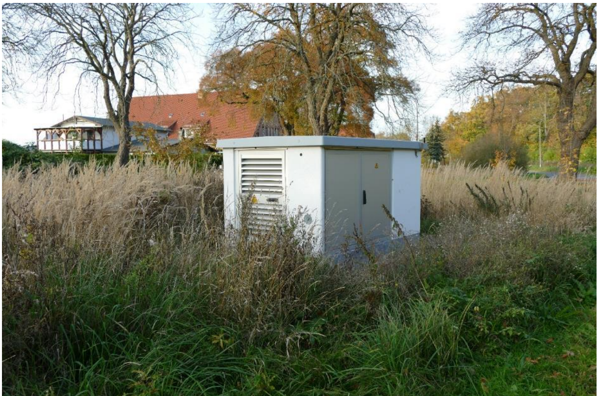
Bild 09 Trafostation im NO, All
