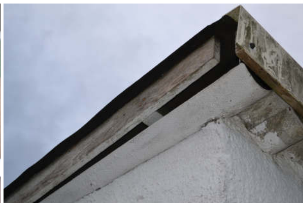
Bild 44: Dachecke (Nr 10, Garten Nr. 7)
