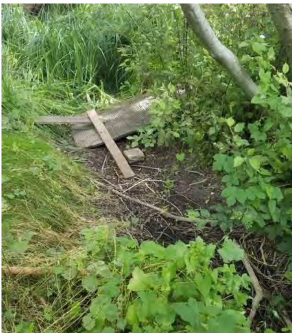
Abb. 9: Regenwasserkanal, Zulauf Ellernbruch (Foto: G. Gerowitt, Juli 2023)
