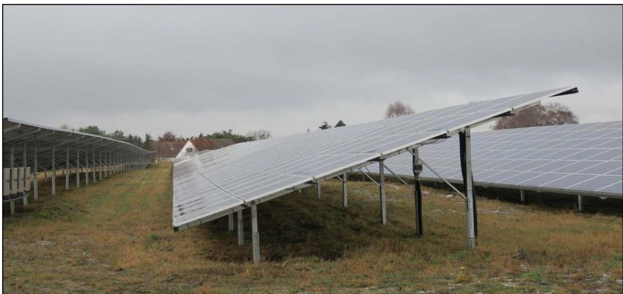
Abb. 1: Beispiel einer vergleichbaren PVA in Mecklenburg-Vorpommern
