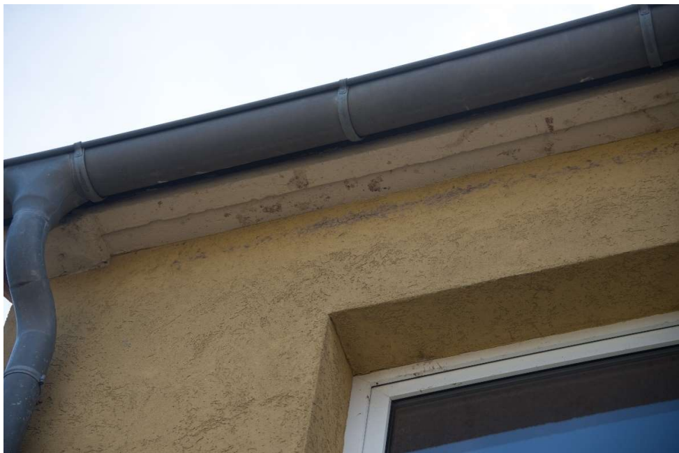
Abb. 7 Reste von Mehlschwalbennestern an der Nordfassade
