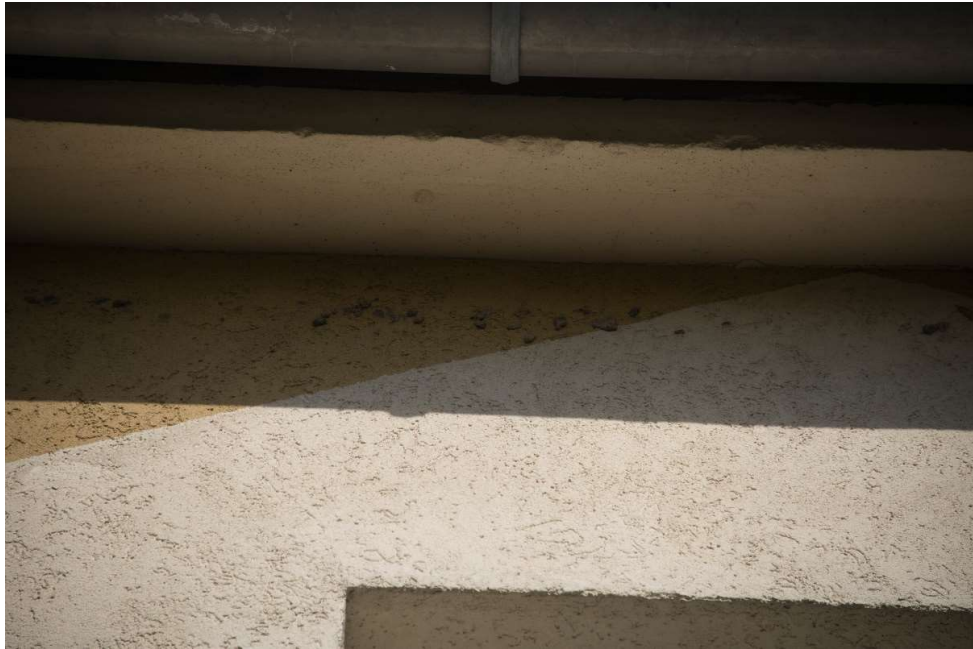
Abb. 6 Reste von Mehlschwalbennestern an der Südfassade
