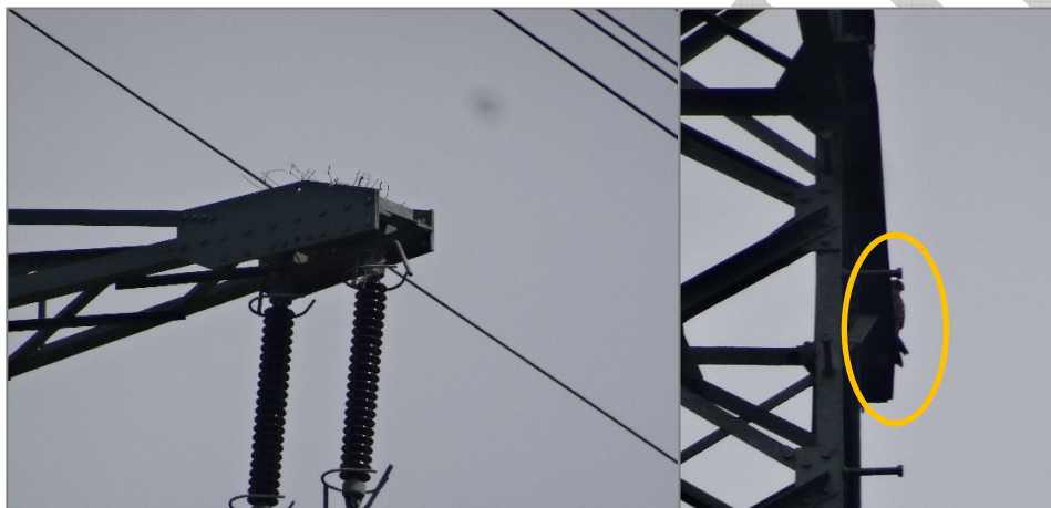
Abbildung 25: Turmfalkennest auf einem Mast der Freileitung und adultes Tier nach Warnrufen/- angriff auf vorbeiziehende Möwen, 07.06.2019.
