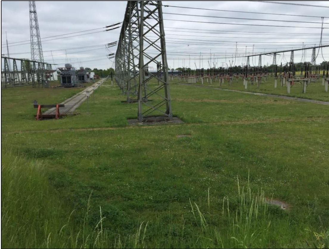
Abbildung 12 Blick in das Umspannwerk (Nr. 32)
