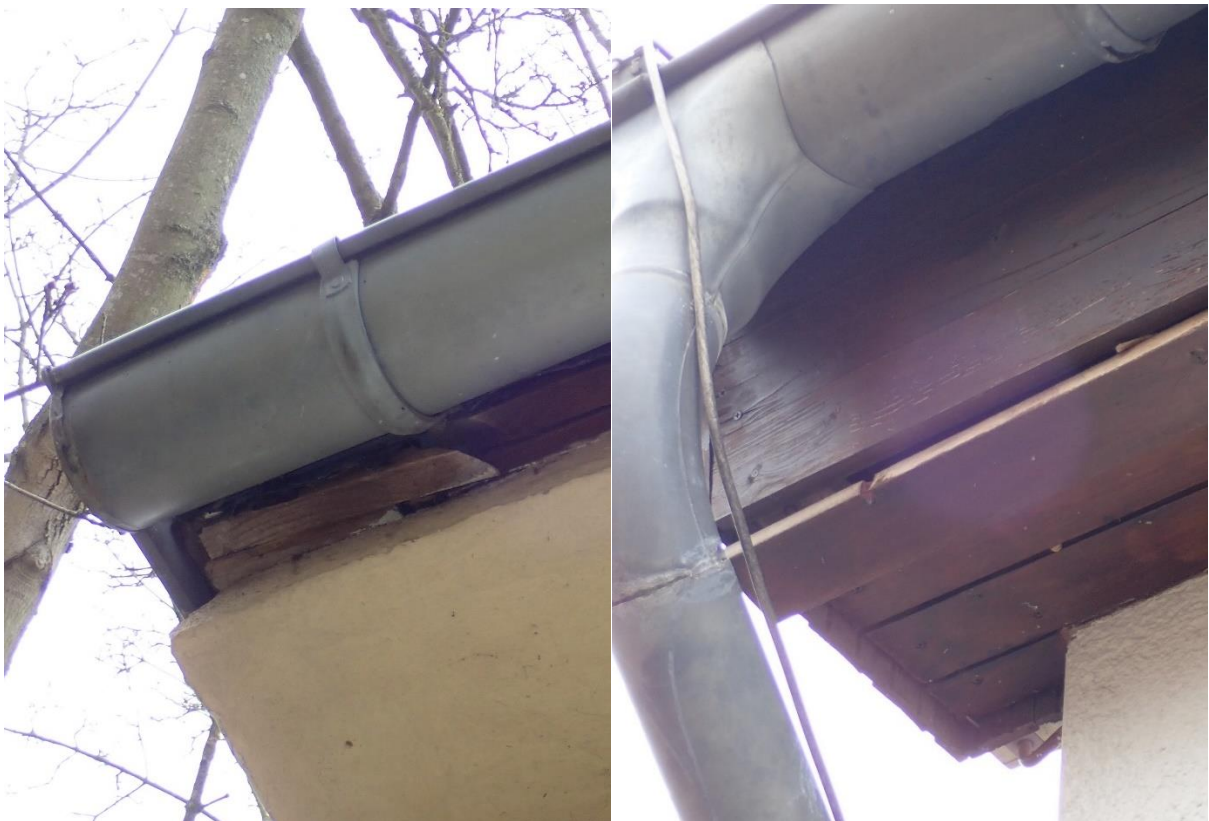
Bild 65 Offene Holzverschalungen an mehreren Gebäude
