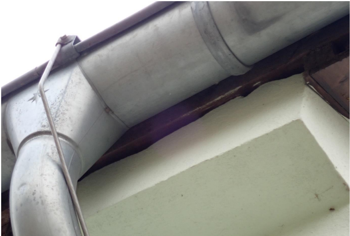
Bild 64 Spalt zwischen Mauerwerk und Dachverschalung Gebäude 7
