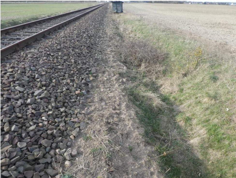
Abbildung 4: Bewegter Oberboden angrenzend an das Gleisbett im westlichen UG am 31.03.2022.
