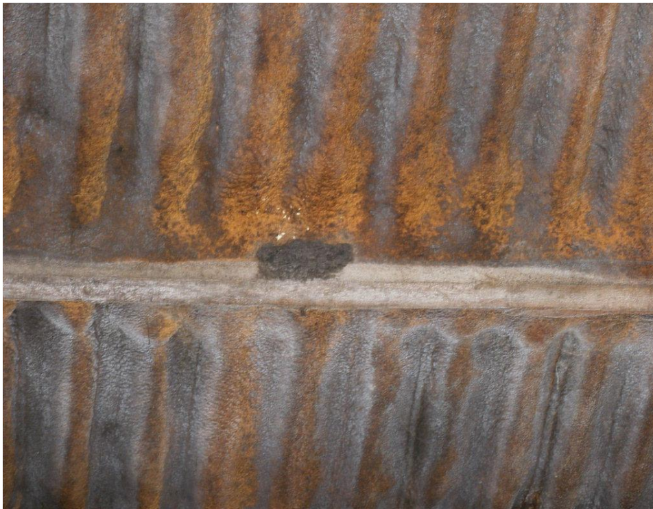
Bild 1.2 Nest von Rauchschwalben an einer Dachpfette Unterseitige Beschichtung der Wellasbestplatten mit Kunststoffschäum
