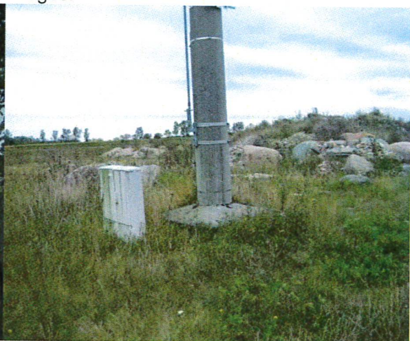
Bild 4 Mast der Mittelspannungsfreileitung und Bauschuttablagerung
